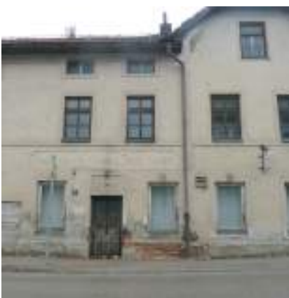
Gebäude mit baulichen Mängeln
